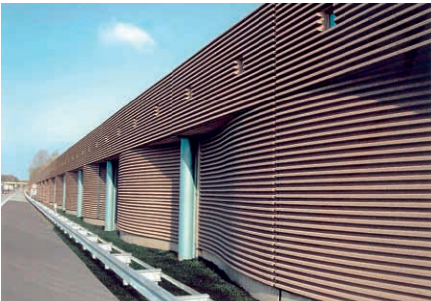
Abbildung 1: Die Oberflächenstruktur von Lärmschutzwänden kann die Lärmabsorption verbessern. Bewährt haben sich Sinusprofilierungen. Fotos: F.C. Nüdling
